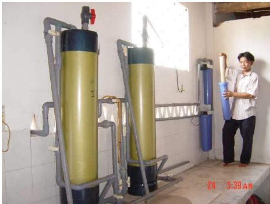
Hình 2.3.7: Hệ thống lọc nước
