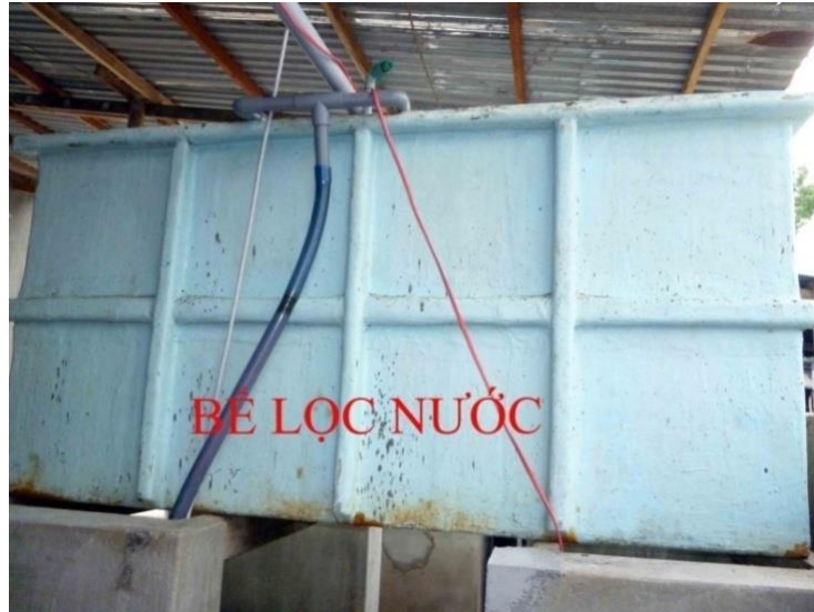
Hình 1.4.3: Bể lọc nước
